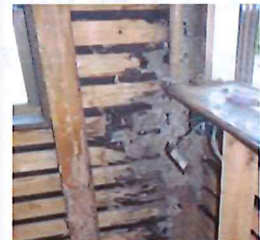
洗面付近がシロアリの被害を受けていた例。浴室等の壁をはがすことで明らかになるケースが多いです。
